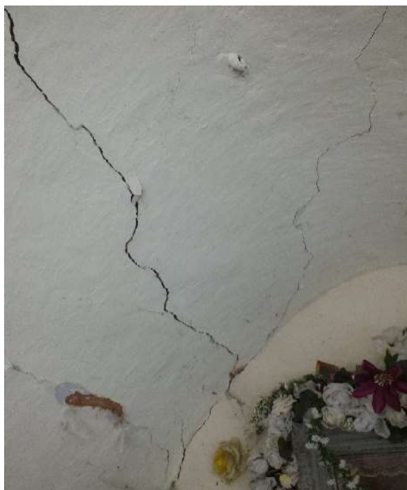
Fot. 7 Spękania we wnętrzu
