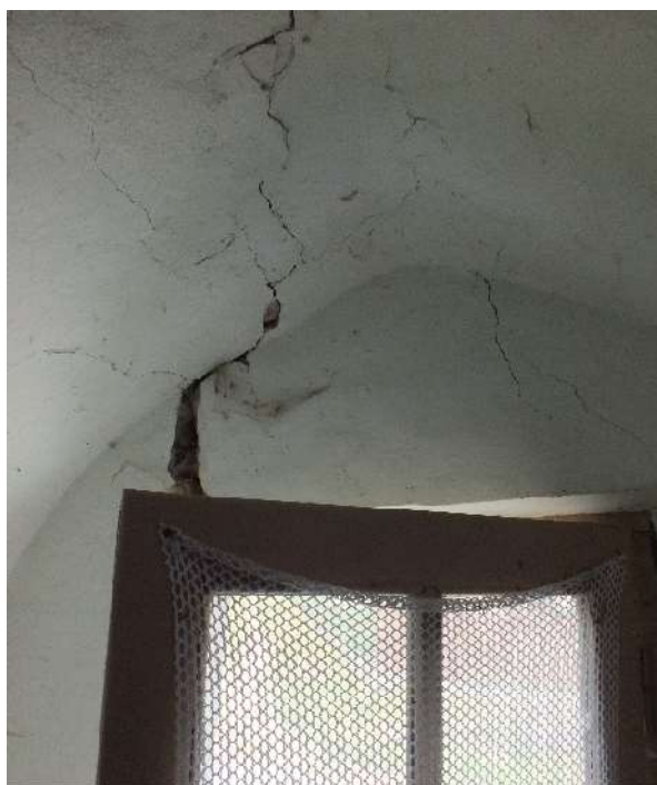
Fot. 8 Spękania we wnętrzu na drzwiach
